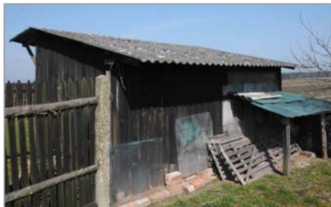
Pokrycie dachowe z azbestu do demontażu
